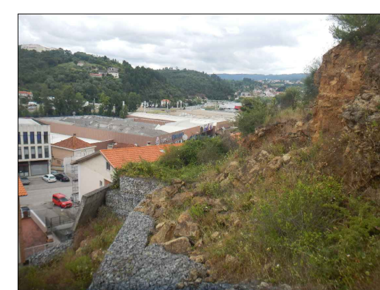
Foto 12 - Limite nascente do talude superior instabilizado, com blocos.
