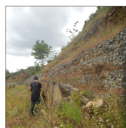
Foto 10 - Bloco caído, de dimensão métrica.
