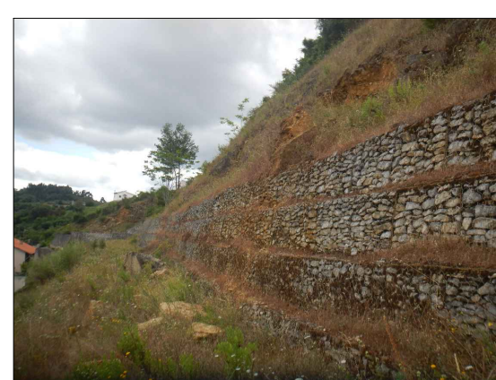
Foto 9 - Queda de blocos e deslizamentos superficiais.
