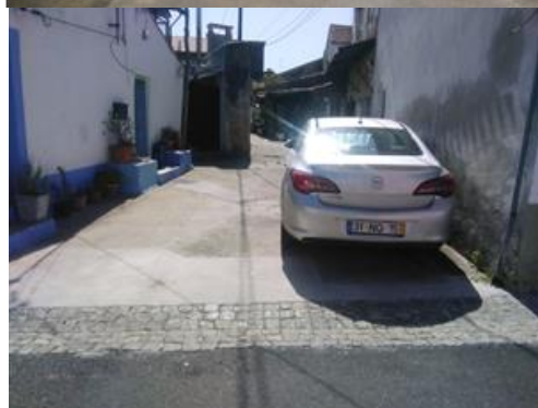
Foto 6 - Estado atual do pavimento do Beco do Leitão n.º 1
