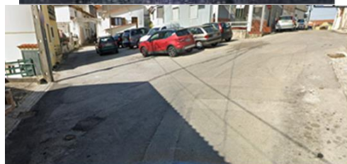
Foto 4 - Estado atual do pavimento da rua do Largo do Cruzeiro
