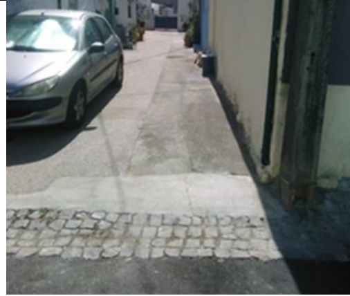
Foto 7 - Estado atual do pavimento do Beco do Leitão n.º 3
