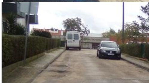
Foto 5 - Estado atual do pavimento da Travessa de São Simão
