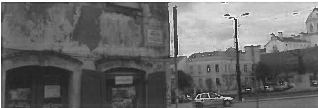
Figura 6 – Edifício em mau estado de conservação localizado na ARU proposta
