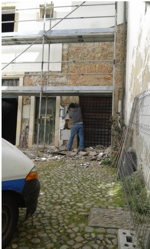
Picagem da fachada principal, visualizando-se o arco de descarga na porta de acesso ao saguão
