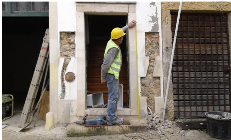
Roços na fachada principal
