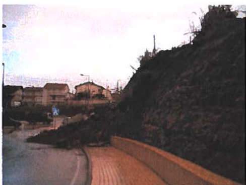
Figura 5.9 – Deslizamento de vertente EN17
