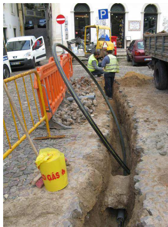
Vala para a rede de gás no Largo da Sé Velha, junto ao ponto de interceção da rede pré-existente.
