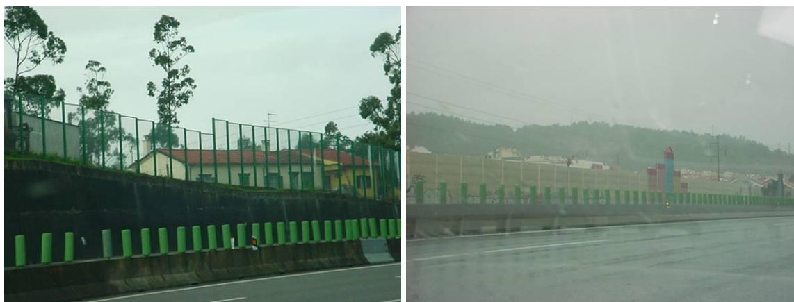
Figura 3- Exemplo de barreiras acústicas transparentes em acrílico (à esquerda) e em painéis metálicos perfurados (à direita).
