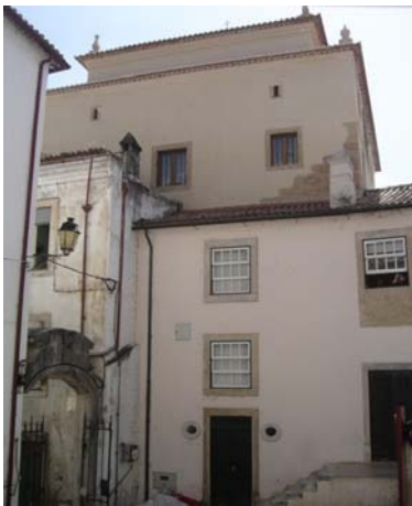
Aspetto final dos trabalhos nas fachadas nascente e norte da Torre de Almedina
