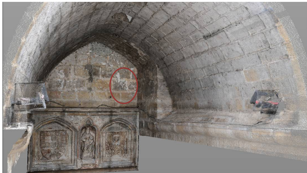
Imagem gerada por nuvem de pontos coloridos, com indicação da zona registada na fotografia anterior e onde é visível a dissimetria da abóbada na zona interior e o recuo do arranque da mesma no lado poente.
