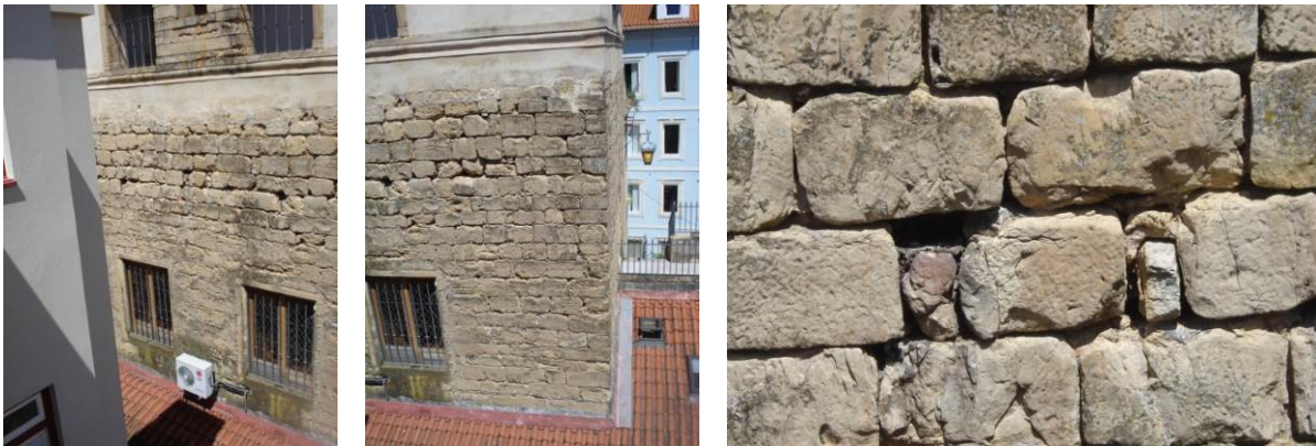
Juntas disfuncionais na fachada poente, antes da intervenção
