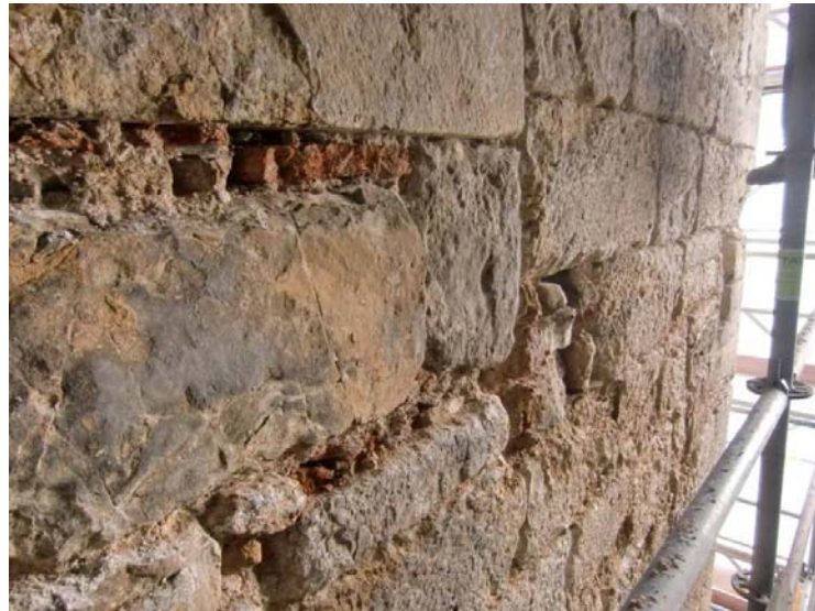
Fotografia obtida após a picagem da argamassa das juntas e se colocou a descoberto a existência de cerâmica de construção entre os silhares do aparelho da [01].
