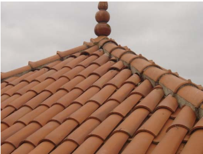
Instabilidade no telhado, com deslizamento de telhas
