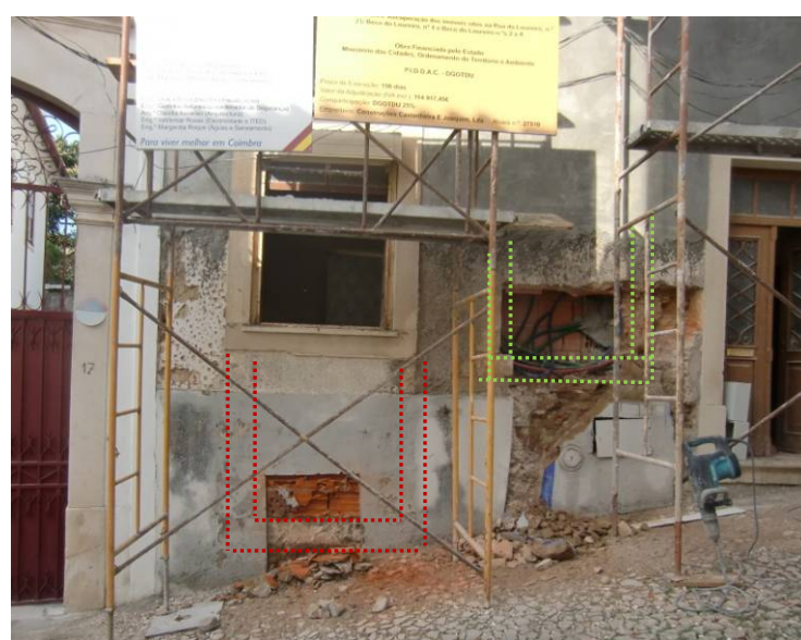
Esquema indicativo do Vão 1 (a verde) embebido na parede e da conversão do Vão 2 (a vermelho) de porta em Janela na fachada da Rua
