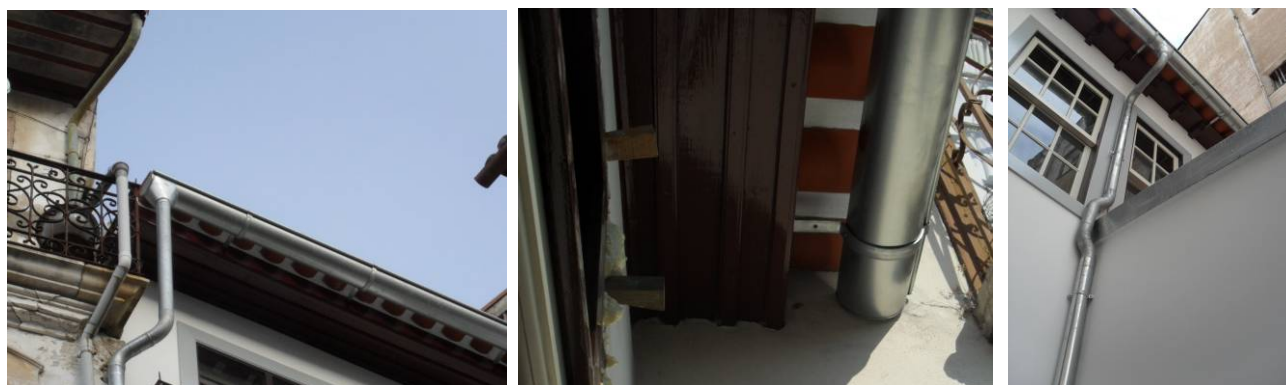
Sistema de recolha e drenagem de águas pluviais
