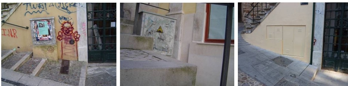
Armários de distribuição de BT existentes (salientes) embutidos em armário dotado de portas - foto à direita.
