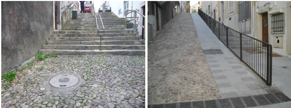
Zona da rampa com escadas laterais alternativas e de acesso às soleiras, situação antes (escadas) e depois da intervenção.
