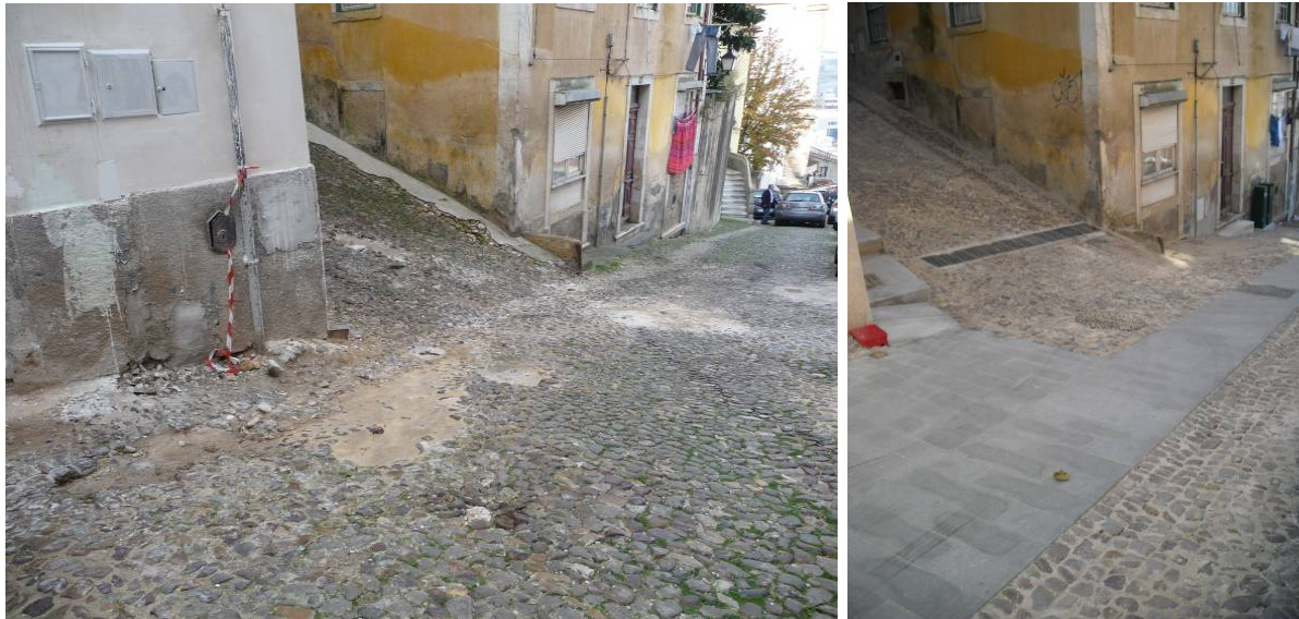
Fundo da Travessa da Esperança situação anterior com o pavimento muito degradado, vazios deixados pela ausência da calçada de seixo rolado, faixas cimentadas junto aos edifícios e vista actual
