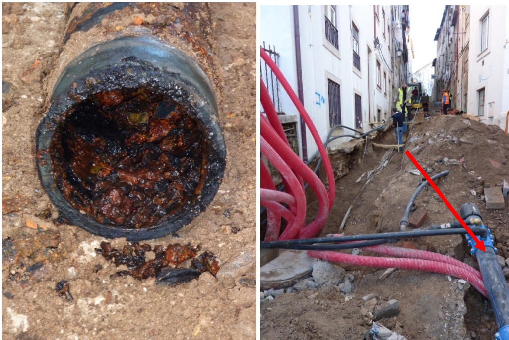
Tubagem antiga em ferro e tubagem nova em PEAD
