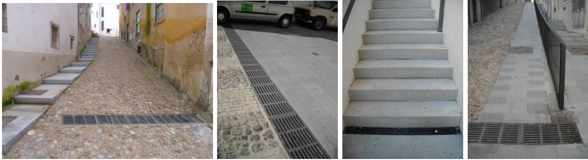
Drenagem de águas pluviais por grelhas transversais.
