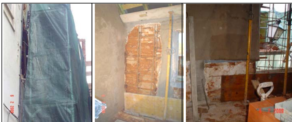
ruína parcial da parede e reforço, pelo interior, com armaduras de aço
