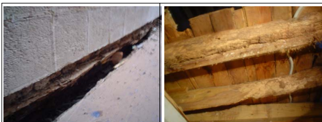
parede "solta" do pavimento
