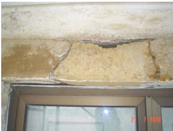
Cantaria de pedra fracturada
