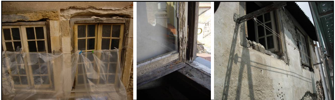
Envelhecimento das caixilharias
