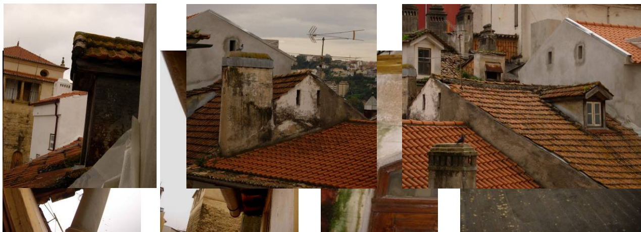
Cobertura e sistema de drenagem pluvial - antes da intervenção
