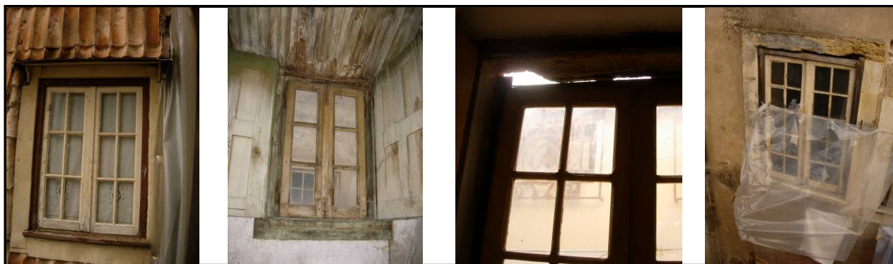
Envelhecimento das caixilharias
