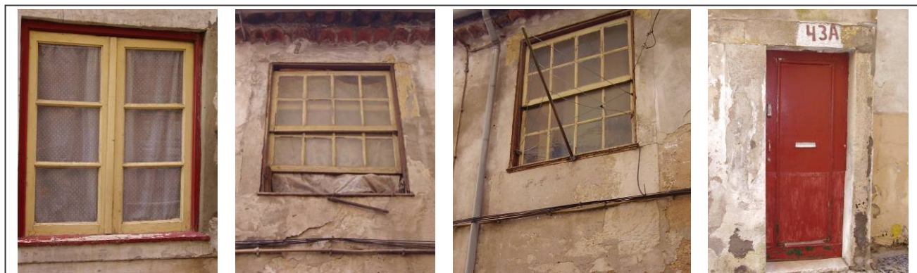
Vãos em madeira empenados com elementos apodrecidos
