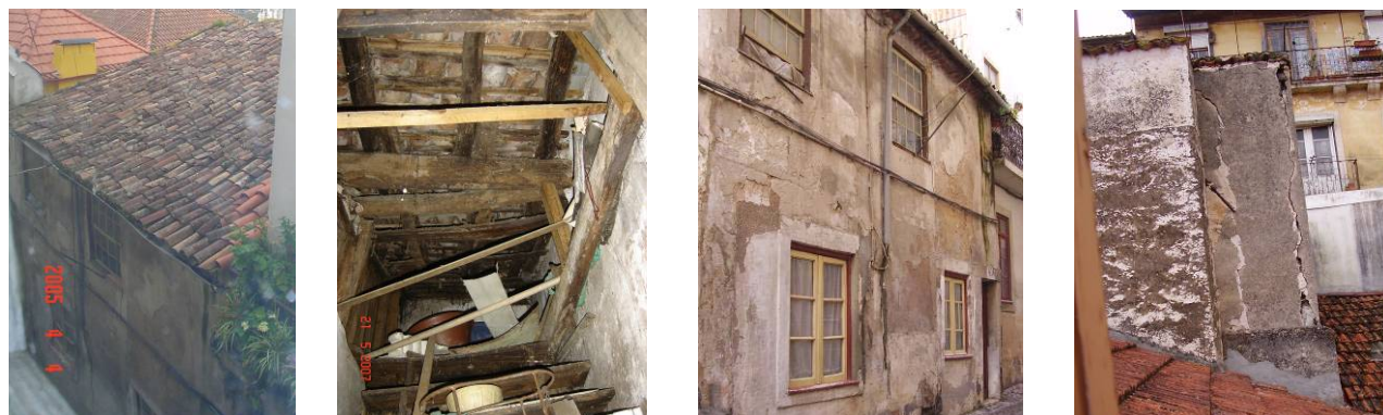
Material cerâmico de revestimento da cobertura e respectiva estrutura de suporte em mau estado de conservação: fachada principal com rebocos desagregados e destacados
