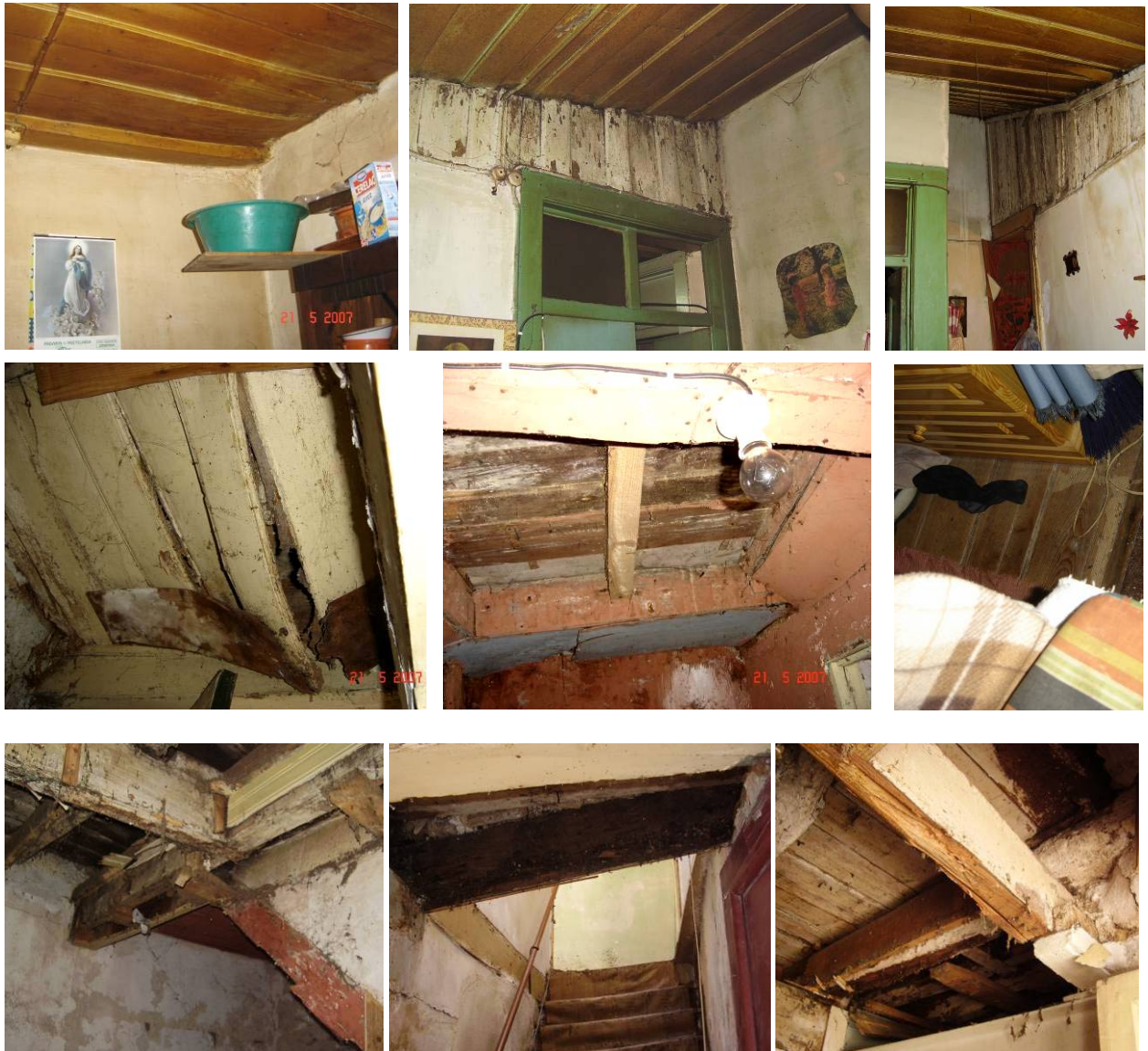
Tectos e pavimentos com grandes deformações e elementos apodrecidos
