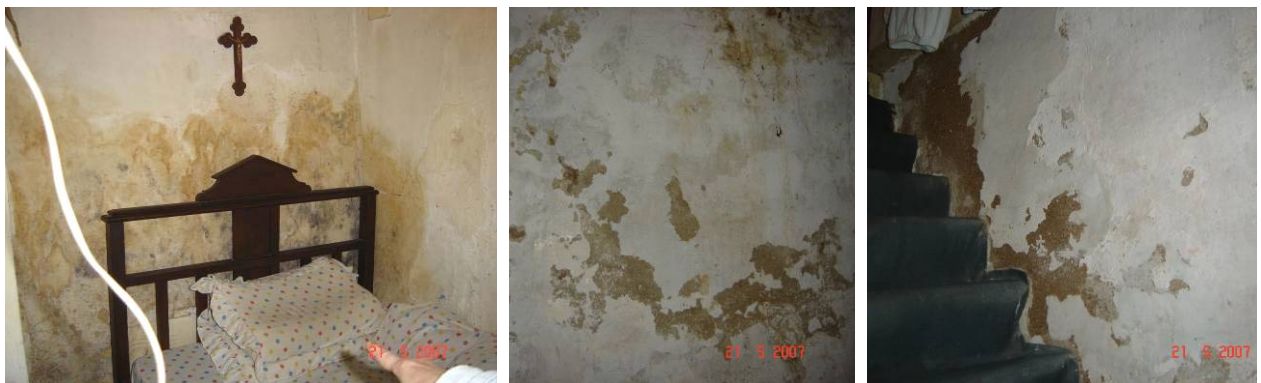
Paredes apresentando pelo seu interior sinais de humidade e presença de sais
