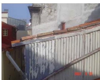
Empena lateral direita em mau estado de conservação e rufagem deficiente
