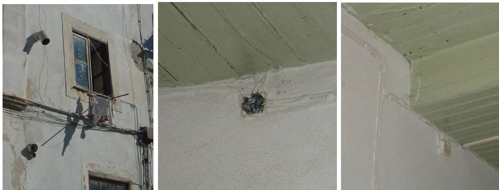
Tubos de exaustão com saída directa para a fachada e instalação eléctrica deficiente
