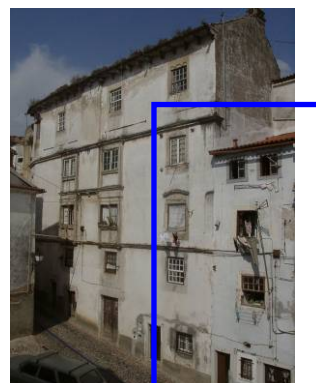
Imóvel antes da recuperação
