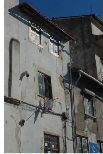
Imóvel antes da recuperação
