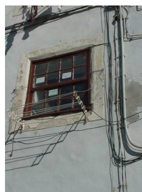
Vão em madeira em mau estado
