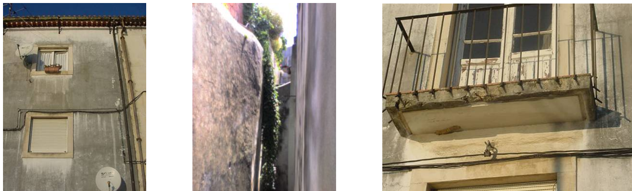
Fachada exterior, saguão e varanda: reboco e pintura degradada, destacamento de betão
