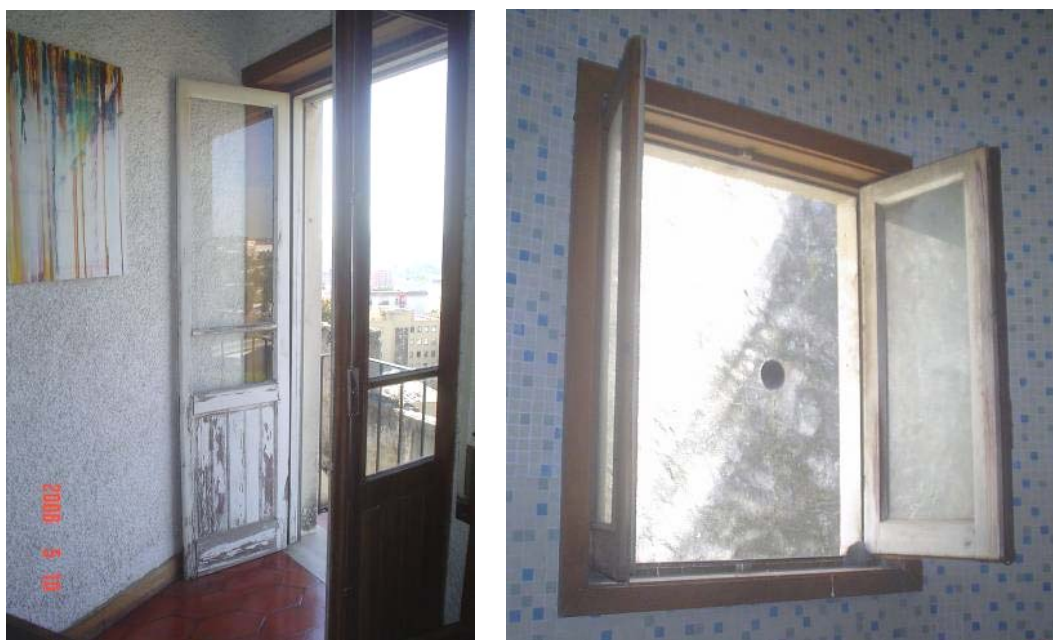
Envelhecimento do revestimento/acabamento das caixilharias
