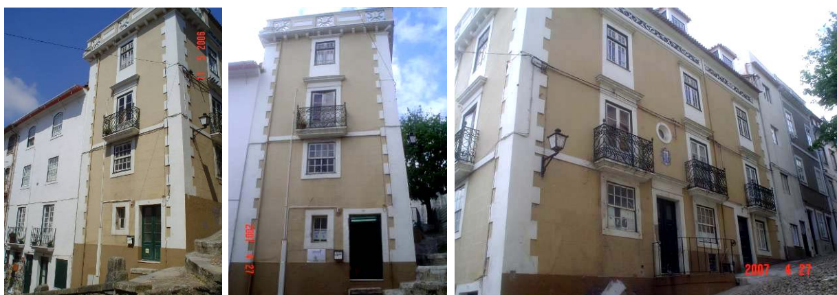
Fachadas exteriores: reboco e pintura degradados
