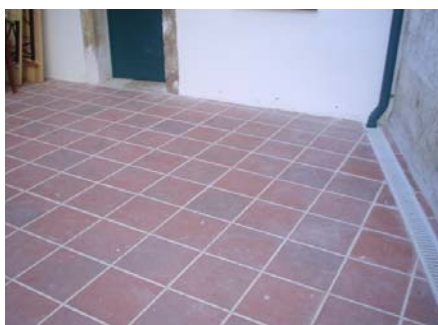
Canalete de recolha para as águas pluviais
