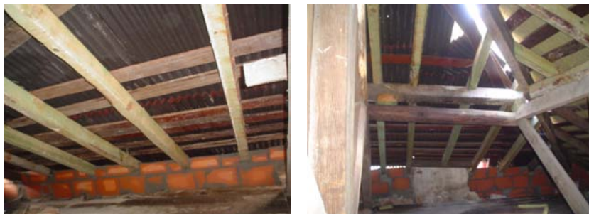
Colocação de barrotes e vigas de madeira para a execução da estrutura de suporte da cobertura
