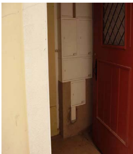
Quadro de colunas, Quadro de serviços comuns e Caixa para medição da resistência de terra
