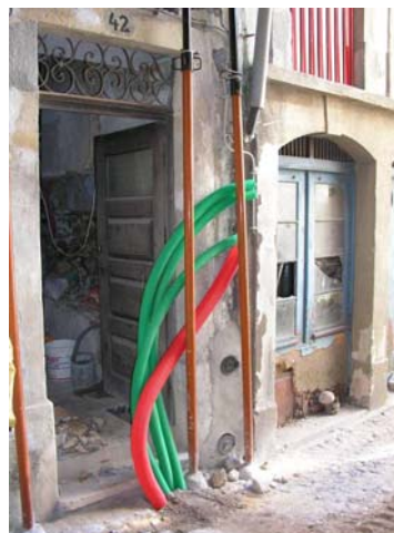
Tubagens para edifício multifamiliar
