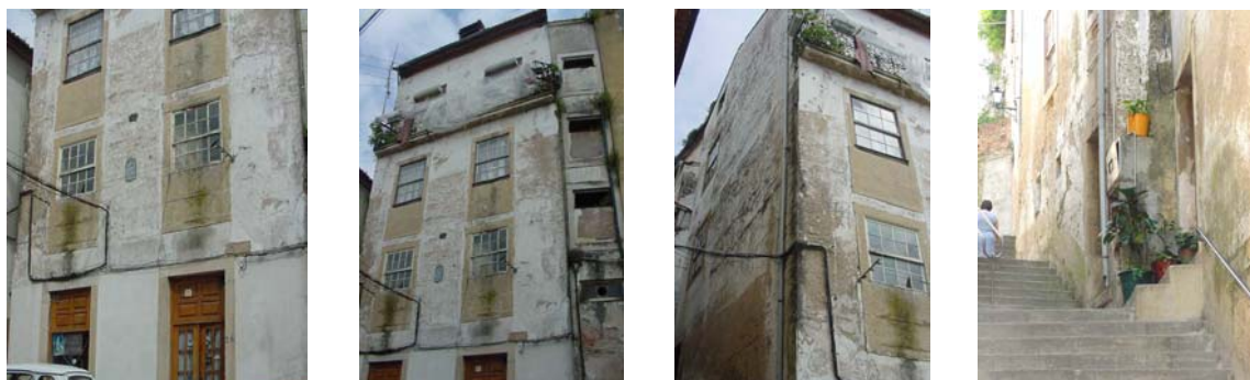
Fachadas exteriores: fendilhação e desagregação de rebocos, pintura degradada
