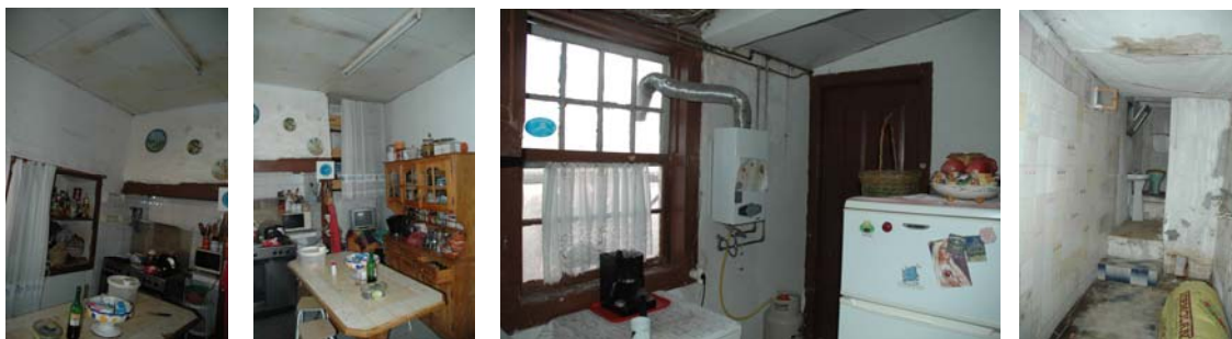
Ventilação e exaustão deficientes/obsoletas
