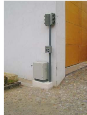
Compressor e semáforo - Rua a Nascente
