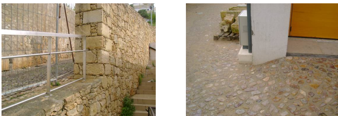
Pormenor de pavimentação da entrada norte do Teatro e de guarda em inox junto à Ladeira do Carmo
