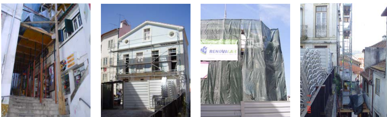
Montagem de andaimes, de rede de protecção e da vedação do estaleiro.
