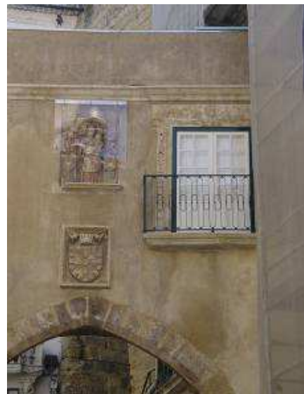
Janela de sacada no alçado Poente; colagem estrutural em fractura de solei
