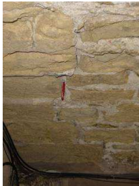
Degradação visível em material de juntas de ligação; fendas expressivas; meteorização superficial de elementos pétreos - intradorso do Arco.
