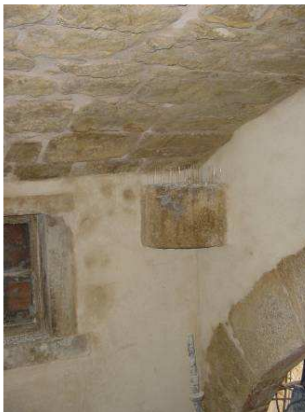
Interior do Arco - janela na parede lateral Sul com sistema anti-nidificação; rebocos tradicionais aplicados
