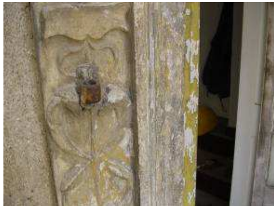
Destacamento de película de protecção de aro de caixilharia; elementos metálicos (corrosão)
