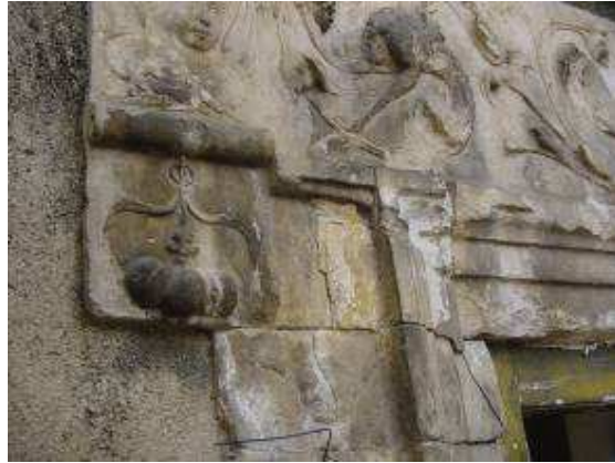
Fracturas em cantarias - moldura recortada da janela de sacada no alçado Poente
