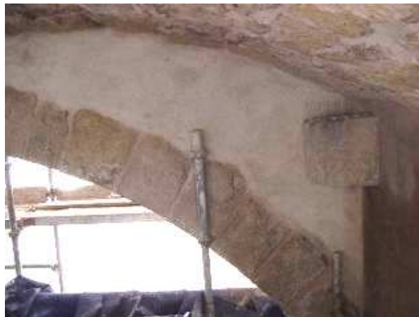
Face interior do alçado Poente - acabamento em reboco tradicional; pormenor de implantação de sistema anti-nidificação no canto
